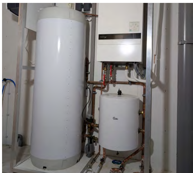
IN DE EIGEN WERKPLAATS SAMENGESTELDE SKID-OPSTELLING
