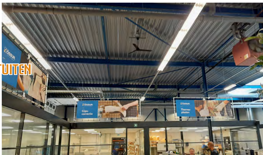
Een ander project waarin ook gebruik gemaakt is van een soortgelijk installatieconcept met airco-units en plafondventilatoren.
