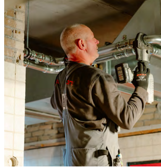
Voor het leidingwerk en de appendages is nieuw materiaal gebruikt. Bron: Lilian Fotografie.
